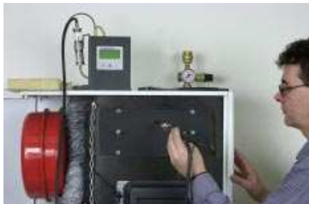
2. Na sprednji strani kotla v čistilnih vratcih je pripravljena odprtina za meritve, ki je različna v kotlu ali 2D od kolena.
